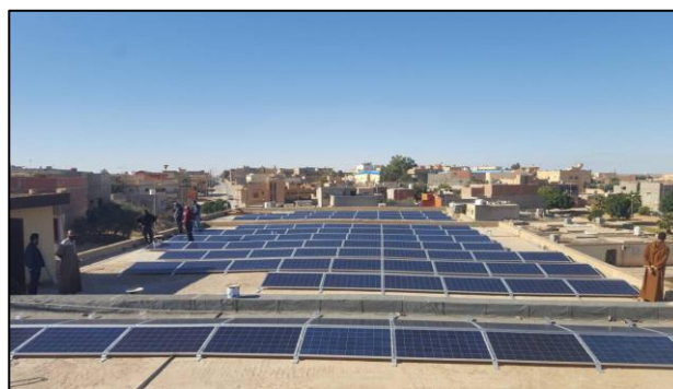
15 hospitaler i Libyen har fået installeret solpaneler for at sikre forsyningen under de mange strømafbrydelser. Genopbygning på sundhedsområdet er central for stabiliseringen af Libyen. Foto fra UNDP.
